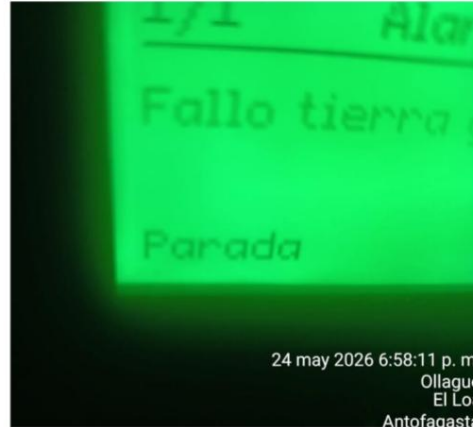
FALLA EN LÍNEA (TIERRA)
