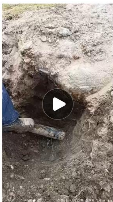
ESTADO SITUACIÓN DEL SISTEMA DE AGUA POTABLE
