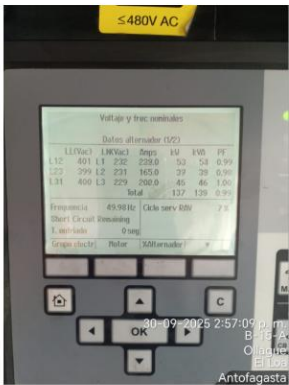
MEDICION DE PARAMETROS DE GENERADOR
