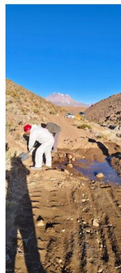
RUPTURA DE CAÑERÍA
